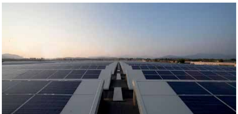
Techos fotovoltaicos de la empresa
