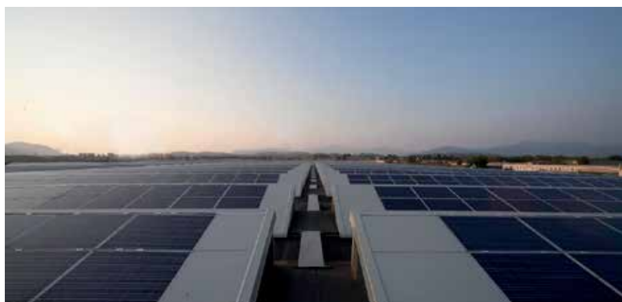
Toiture photovoltaïque de la société
