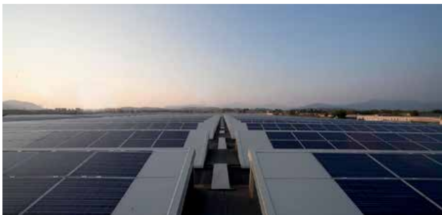
Крыша здания компании, выполненная из фотоэлементов
