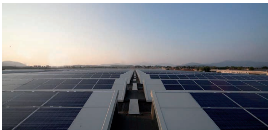
Teto fotovoltaico da Companhia
